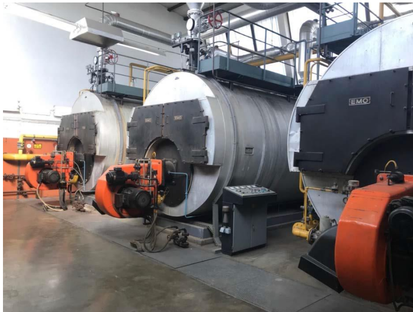
Obstoječa kotlovnica znotraj (trije vročevodni kotli, letnik 1985)
