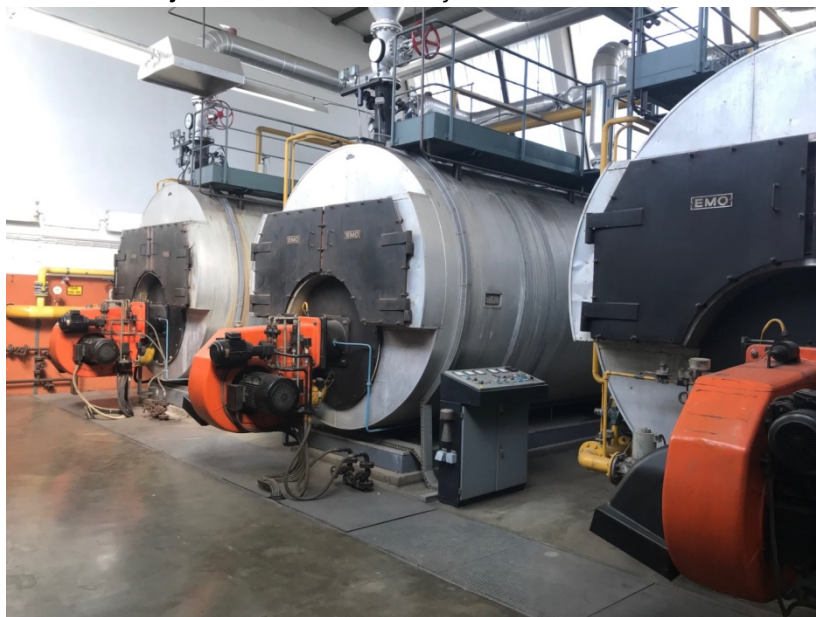
Slika 2: Obstoječa kotlovnica - znotraj
